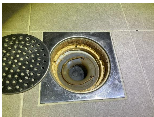
Bild 6: Våtrum. Går ej att bekräfta om tätskikt/brunnsmanschett förekommer eller ej då bruk/fix döljer området ner mot klämring.
