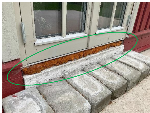
Bild 2: Dörrar. Tröskelbleck alternativt tätning saknas på ytterdörrar.
