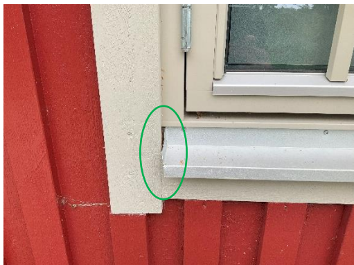
Bild 1: Fönster. Lokala otätheter noterades på fönsterbleckens uppvik på sidorna.
