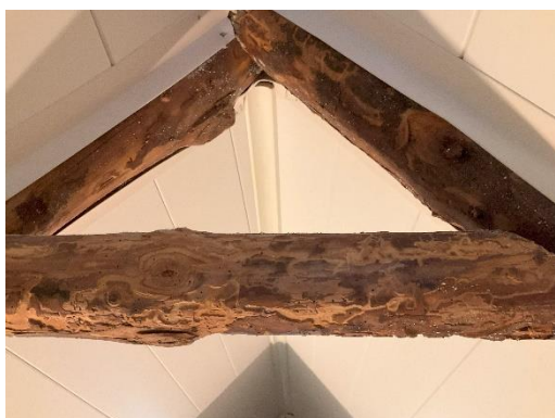
Bild 5: På äldre takstolar förekommer träskadedjursangrepp.
