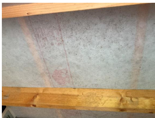
Bild 4: Förråd (baksida). Förekommer fläckar på väv mot insida yttertak.
